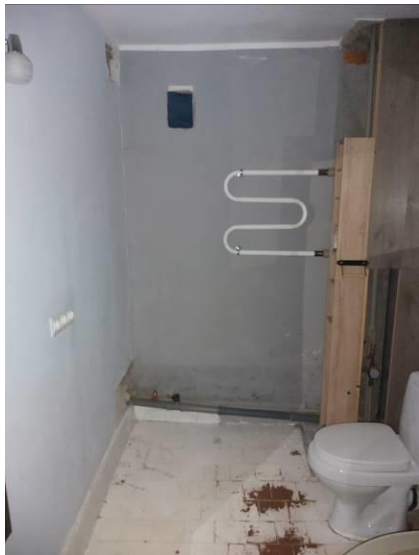
Savienotā sanitārtehniskā telpa
