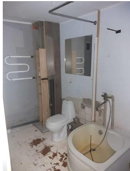
Savienotā sanitārtehniskā telpa
