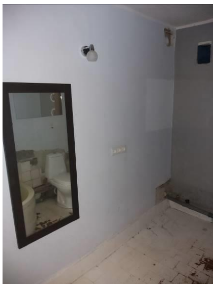
Savienotā sanitārtehniskā telpa
